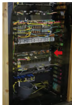
ShowNetのMedia over IP伝送デモで稼働中のルータ「FX201」(←の機器)
